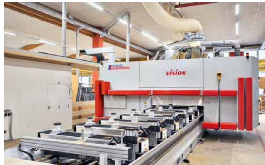
Unten: Das größere Modell der „Vision II Sprint“ verfügt über einen automatischen Trägertisch. Rechts: In der Absauganlage wurde eine spezielle Weiche eingebaut, die Holz- und Gipsabfälle trennt
